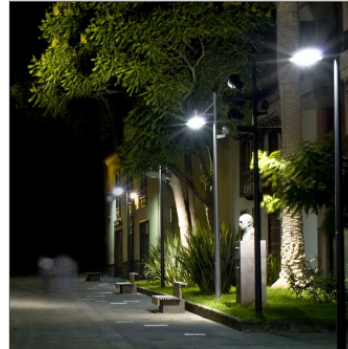
Straßenbeleuchtung Aufsatzleuchte mit asymmetrisch bandförmiger Lichtverteilung schlichte Form, die sich in Umgebung einpasst
