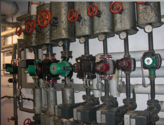
Heizungsverteiler im Beverbad
