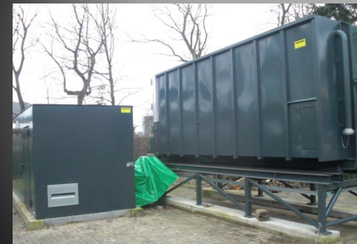
Holzheizung im Container, mit Holzbunker
