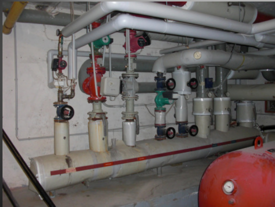
Heizungsverteiler mit Pumpen in der GS I
