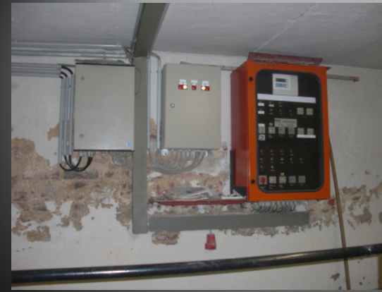
Regelanlage in der GS I
