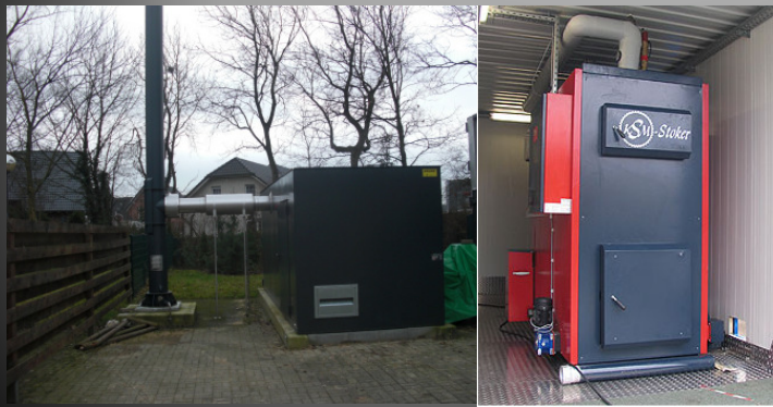
Holzheizung im Container, freie Aufstellung
