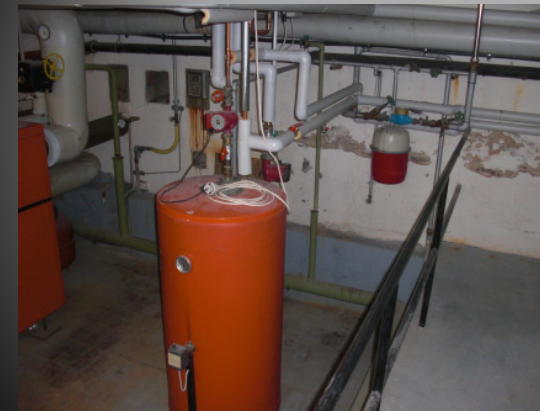
Wärnwassererzeugung in der GS I
