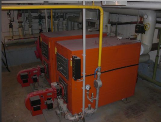
Erdgaskesselanlage in der GS I
