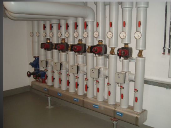
Heizungsverteiler, neu gedämmt mit elektronischen Pumpen
