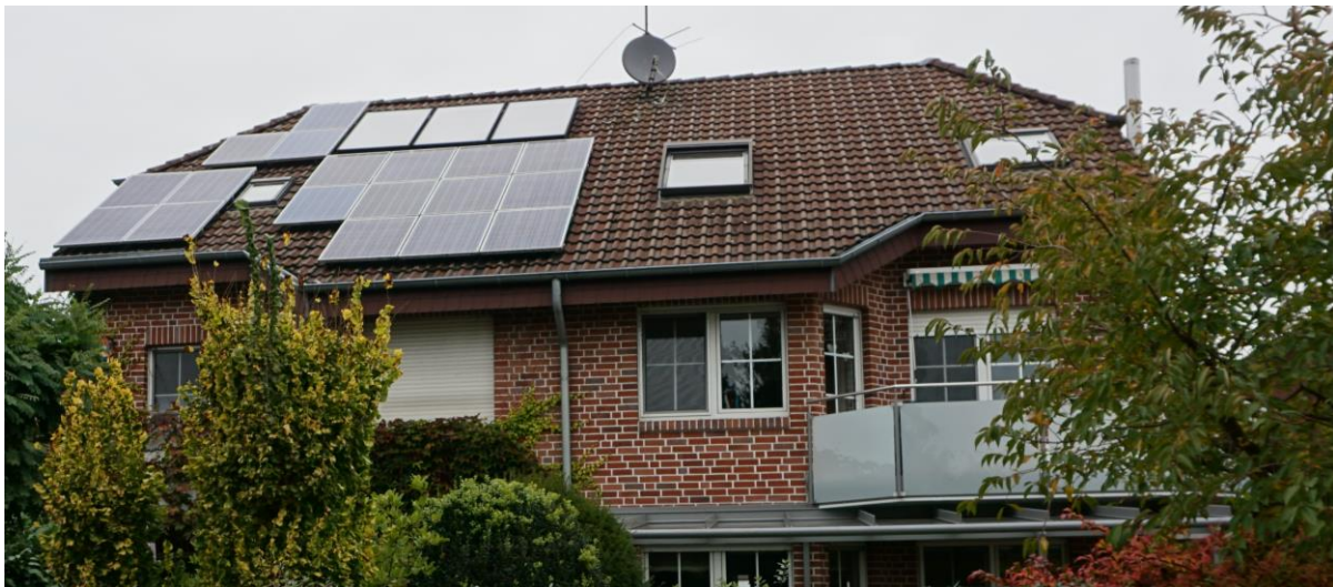
Abbildung 2-17: Installierte PV- und Solarthermie-Anlage (Eigene Aufnahme).
