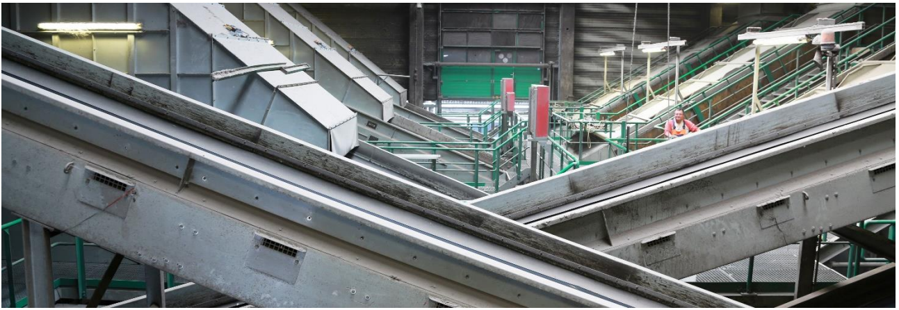
Abbildung 10: Blick in die Grobaufbereitung der MBA-Anlage
